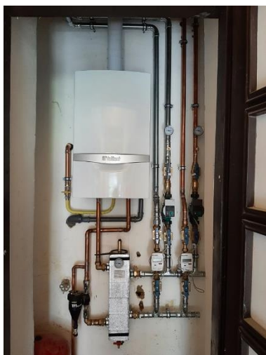
Takarítószeres raktárából kazánház
